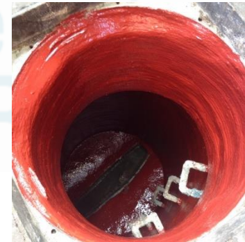
Alcantarillado y sistemas de transporte de aguas residuales
